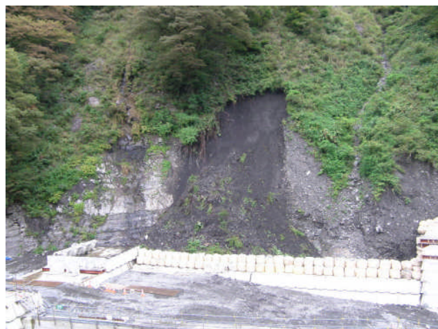
<施工期間内に発生した崩落>
