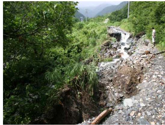
平川（白馬村）での被災状況
