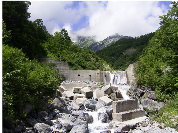
被災した北股第2号砂防えん堤
