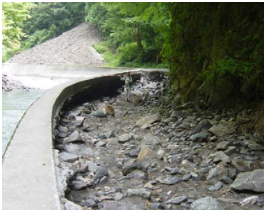
島々谷川（松本市）での被災状況
