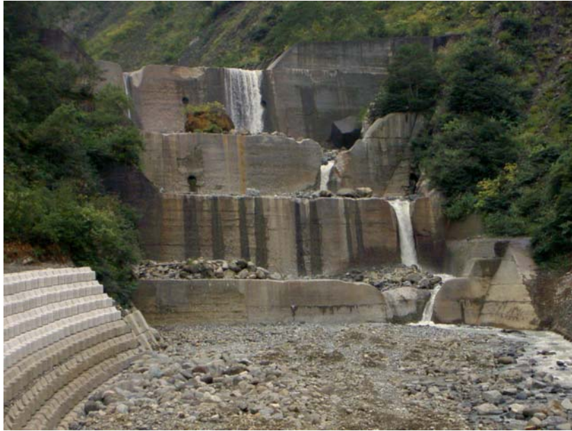
水通し部の摩耗が著しい砂防えん堤
