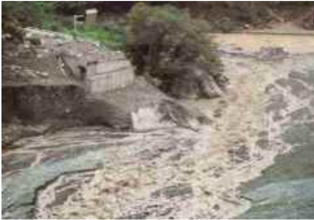
写真 2.47 土石流により流出した新国界橋（蒲原沢） (長野県土木部, 1995 b)
