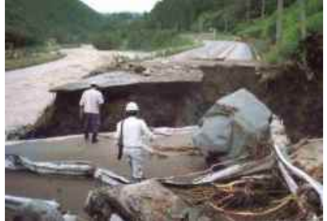
写真 2.48 土石流で切断された道路（小谷村松沢橋） (長野県土木部, 1995 b)
