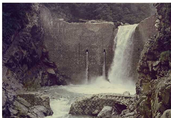
昭和45年の大出水による破損
