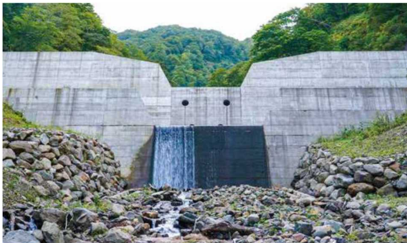
CIGrCo（不透過型・重力式コンクリート堰堤）
