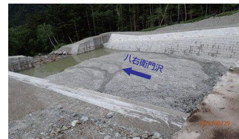
被災後 令和元年8月29日
