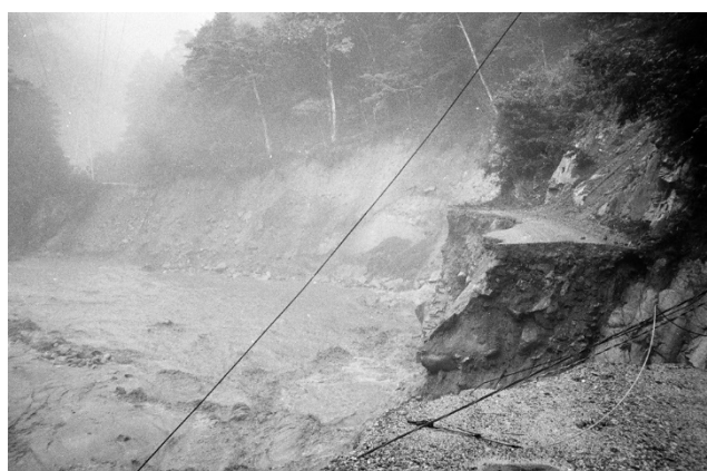
写真 4.17 県道槍ヶ岳線の欠壊・仙人閣の下流 100m付近（松本砂防工事事務所，1969）
