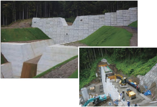
写真 5.13 ① 家の上沢 大町市美麻 家の上沢砂防堰堤（長野県） （長野県砂防課，2022）
