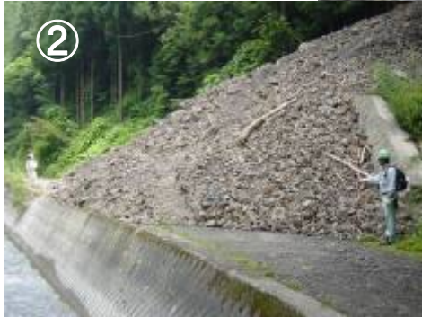
② 支流からの土砂流出
