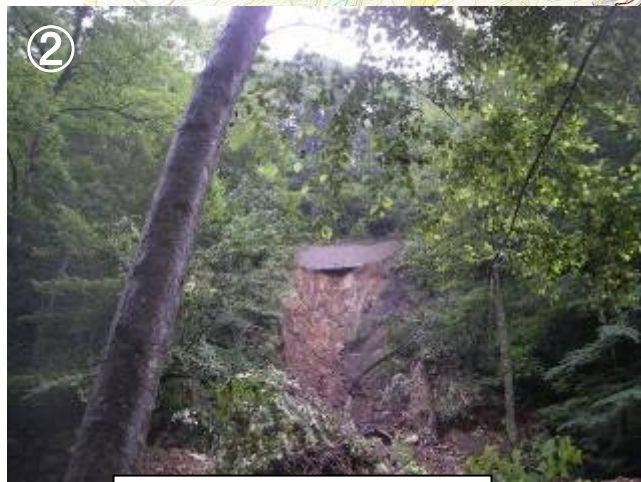
ソグラ沢林道崩落 写真提供:松本市奈川支所
