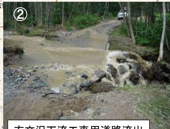
玄文沢下流工事用道路流出
