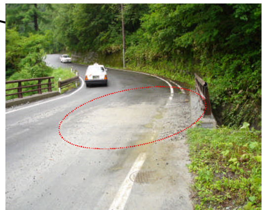
平成20年7月28日の出水では土石流の一部が産屋沢橋を乗り越えた。
