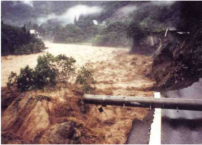
写真 2.45 姫川によって流出した国道 148 号 (新潟県土木部河川課・糸魚川土木事務所, 1996)
