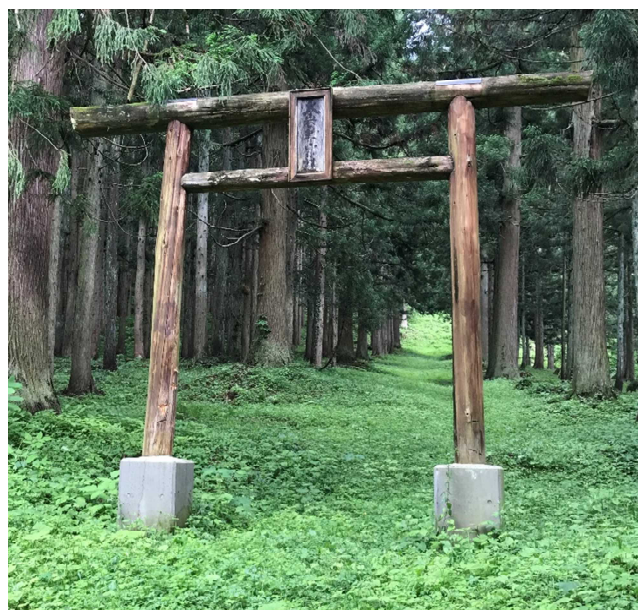
写真 2.13 大岩若宮社の鳥居, 2019 年撮影 (2014 年の神城断層地震で変形したため、鳥居の脚部は補修された。)
