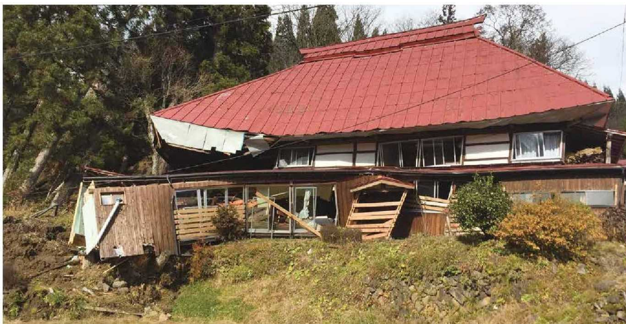
写真2.56 建物に達した崩落土砂
