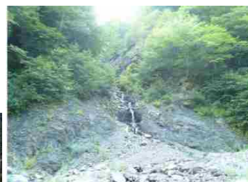
堰堤上流斜面崩壊状況
