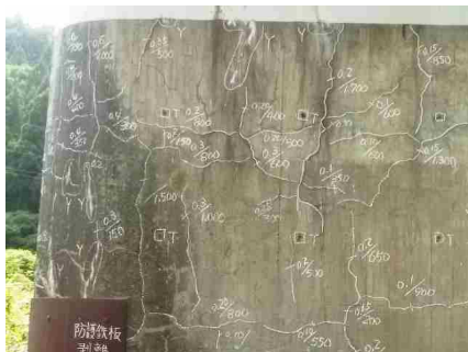
損傷状況 橋脚のひび割れ
