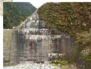
本堤遊離石灰・ひび割れ
