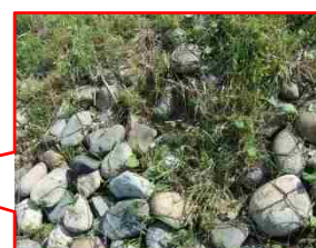
蛇籠鉄線の破断
