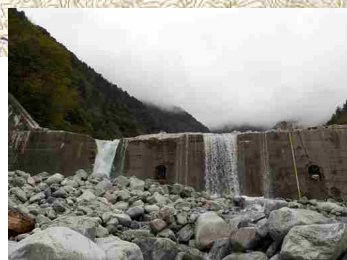
本堤水通し天端摩耗
