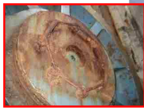
ゲート主ローラの腐食
