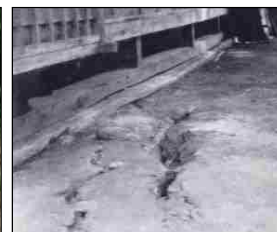
H6年頃 袖の沢地区の地割れ
