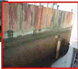
ゲート扉体部の発錆
