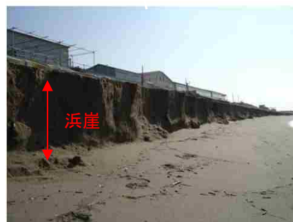
金衛町工区被災状況(平成18年9月)
