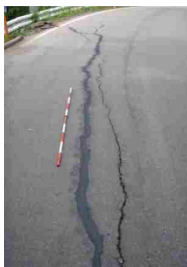
県道折戸飯田線 被害状況
