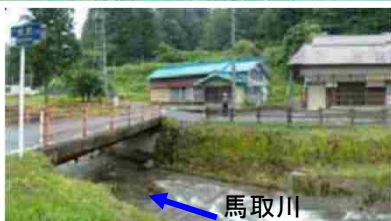
【保全対象】荒沢(水上沢)集落 人家6戸、公民館1箇所 等
