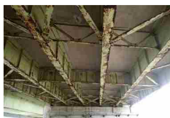
（鋼部材の塗装劣化）
