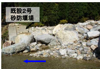
既設砂防堰堤の異常堆砂状況
