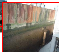
ゲート扉体部の発錆
