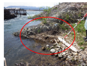
低水護岸・蛇籠の流出
