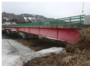
（鋼部材の塗装劣化）
