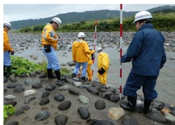
堤防点検により変状を確認
