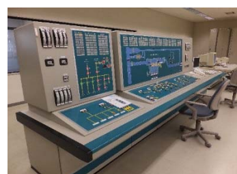
②老朽化した運転操作システムの更新
