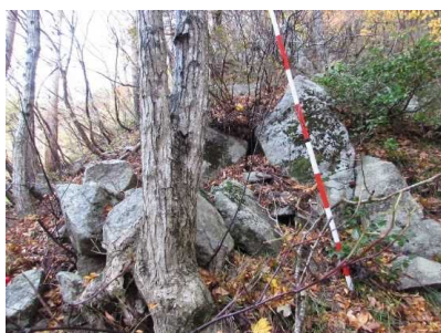
法面の岩塊状況
