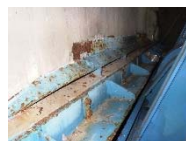
戸当りの腐食
