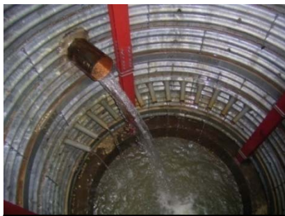
松坂地区 集水井
