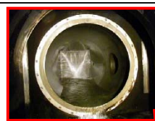
副ゲート(副バルブ) からの漏水
