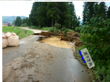
下流の被災状況
