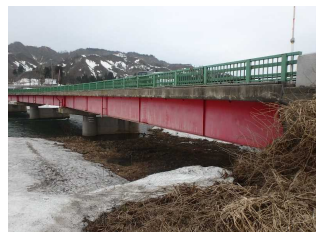
（鋼部材の塗装劣化）
