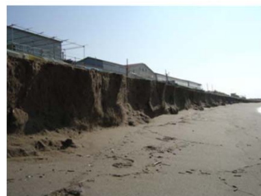
金衛町工区被災状況(平成18年9月)
