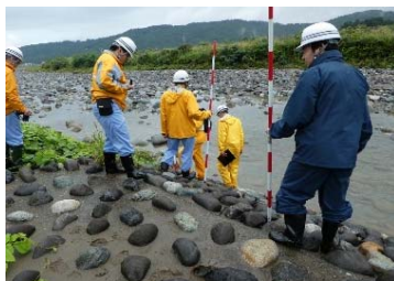
堤防点検により変状を確認
