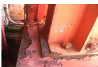
屋外開閉装置部の腐食
