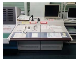
放流警報監視装置
