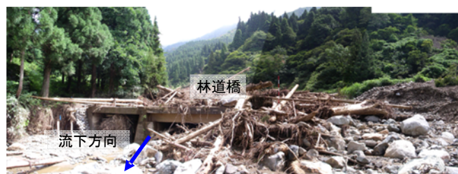
既設林道の被災状況
