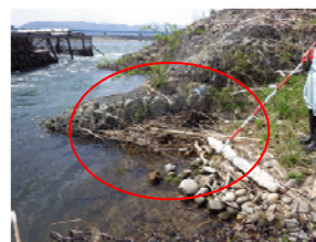
低水護岸・蛇籠の流出
