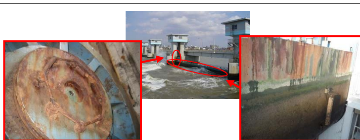
ゲート主ローラの腐食
