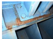
扉体上部の腐食
