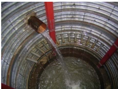
松坂地区 集水井
