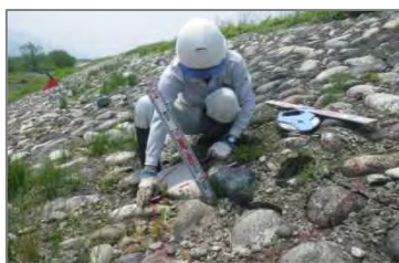
堤防点検により変状を確認
