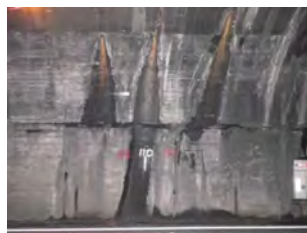
（覆工コンクリートのひび割れ）
