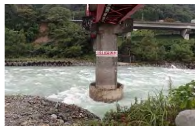
〈P1橋脚 洗掘状況〉
