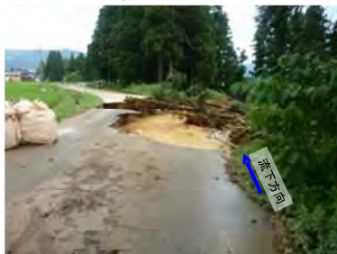
下流の被災状況
