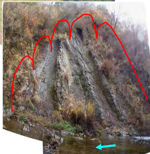
大規模崩壊斜面状況
