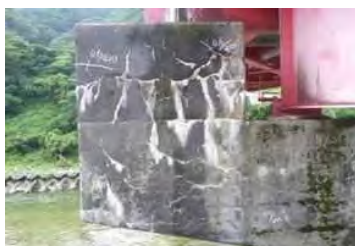
〈P1橋脚 損傷状況〉
