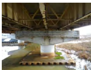
（鋼部材の腐食及び塗装劣化）
