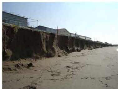
金衛町工区被災状況(平成18年9月)
