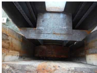
ゲート主ローラと戸当たり部の腐食
