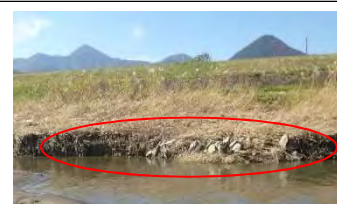
蛇籠護岸の流出
