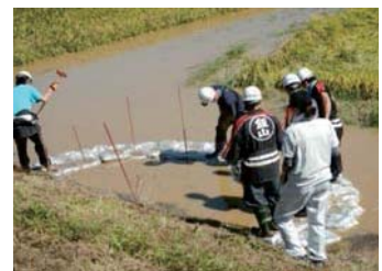
H25年9月洪水時の漏水状況
