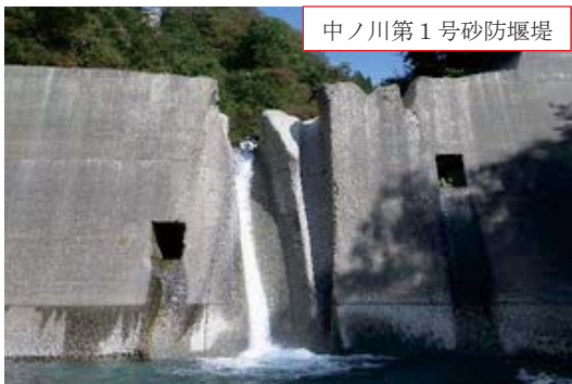
本堰堤損傷状況
