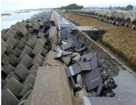
離岸堤開口部の堤防倒壊状況 (H20. 2. 24)
