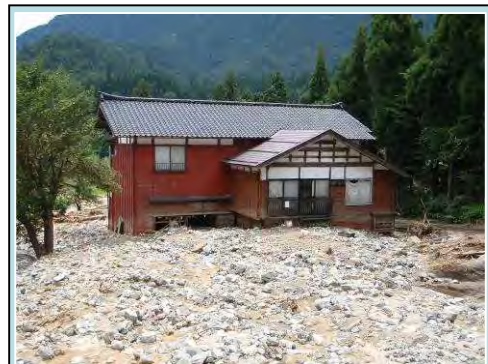
被災した溪流直下流の家屋
