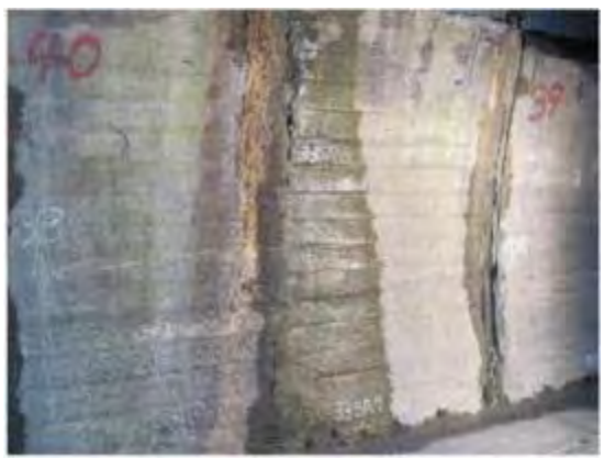
(壁面のひび割れ・漏水)
