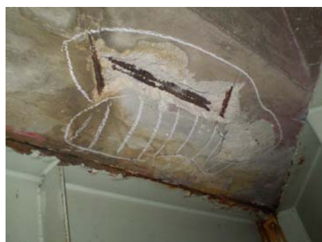
【床板の剥離・鉄筋露出状況】
