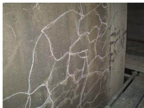
【橋脚のひびわれ状況】
