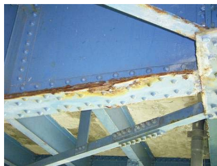
塗装の劣化状況
