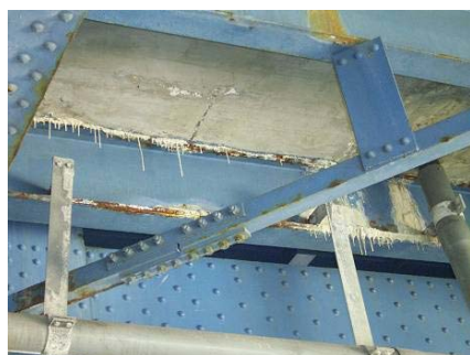
床版に遊離石灰を伴う漏水
