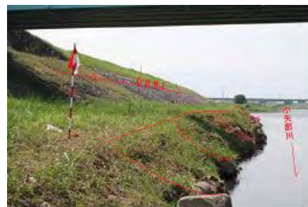
経田地区被災状況
