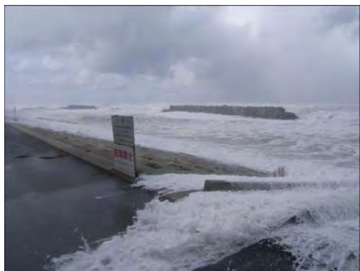
平成20年2月の越波状況
