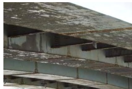
千歳大橋 腐食状況写真
