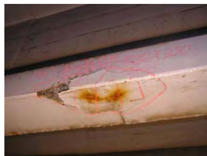
損傷状況写真
