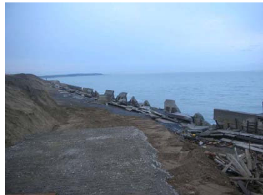
小松工区浜佐美地先での護岸被災状況 (平成18年12月)
