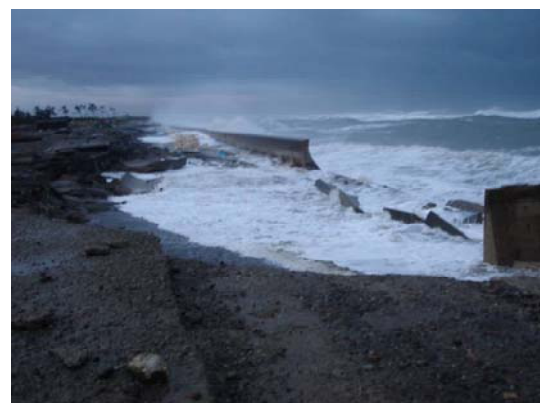
小松工区安宅新地先での護岸被災状況 (平成17年11月)
