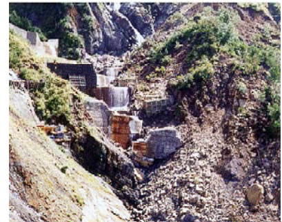
H4年の出水による柳谷第3号、第6号砂防えん堤の被災状況
