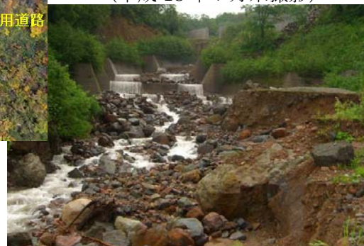
兎谷砂防えん堤群直下の河床低下 (平成 18 年 7 月末撮影)
