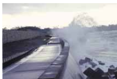
片山津海岸での越波状況（平成14年1月）
