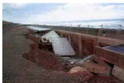
小松海岸陥没状況（平成16年1月）
