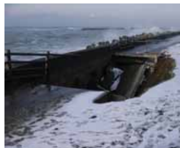
小松海岸陥没状況（平成17年2月）
