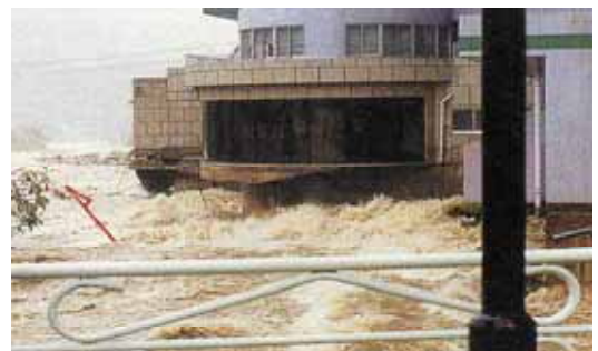
H10.9出水被災状況(マンション基礎洗掘)
