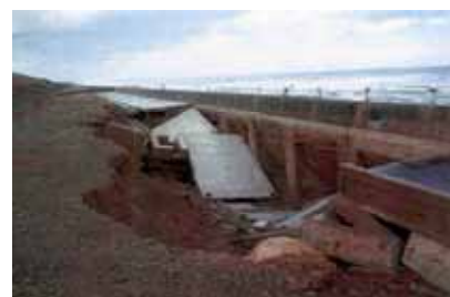
小松海岸陥没状況（平成16年1月）
