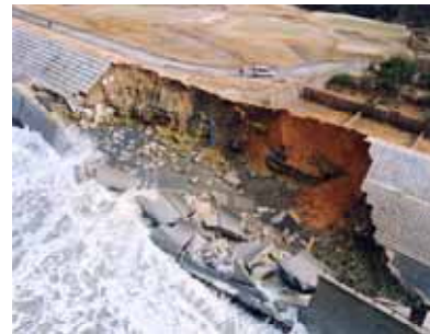
小松海岸での被災状況（平成12年1月）
