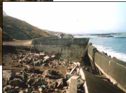
被災状況（平成13年2月撮影）
