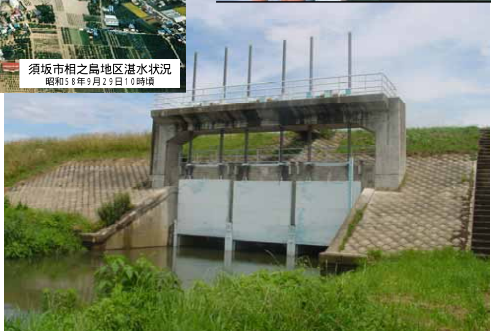
老朽化が進んでいる百々川樋門
