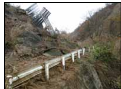
迂回ルート区間の被災状況 (小千谷方面から魚沼方面を望む)
