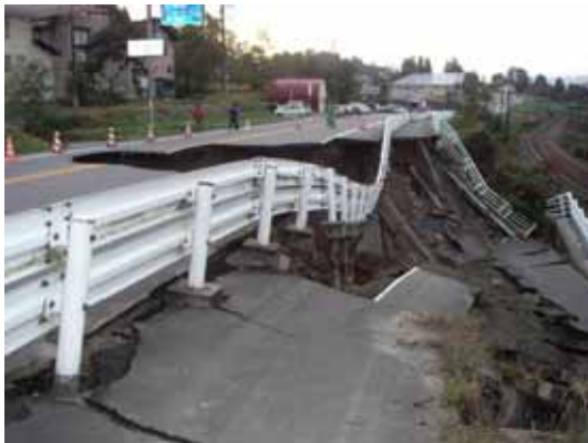
てんのう 国道17号川口町天納 道路崩壊（H16.10.24撮影）
