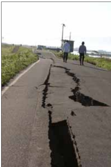
堤防天端の亀裂被害状況 【中之島町長呂地先】 H16.10.24 撮影
