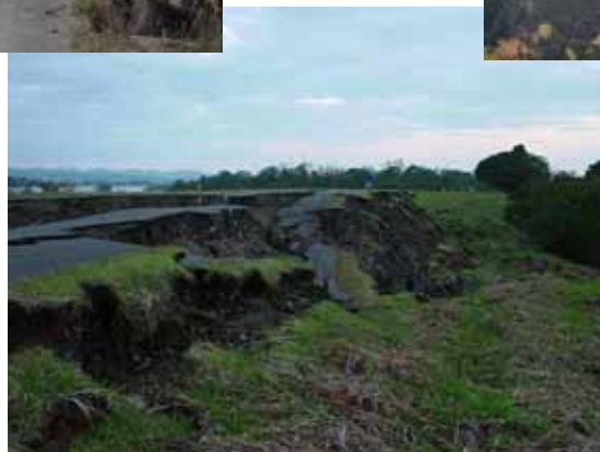
さんびょうの 信濃川右岸長岡市三俣野 堤防裏法崩壊（H16.10.24撮影）
