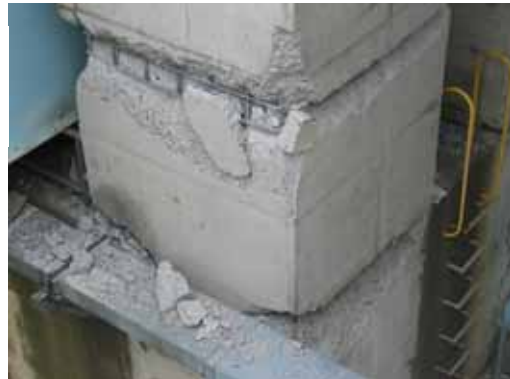
妙見堰の堰柱損傷状況 【長岡市妙見地先】 H16.10.25 撮影
