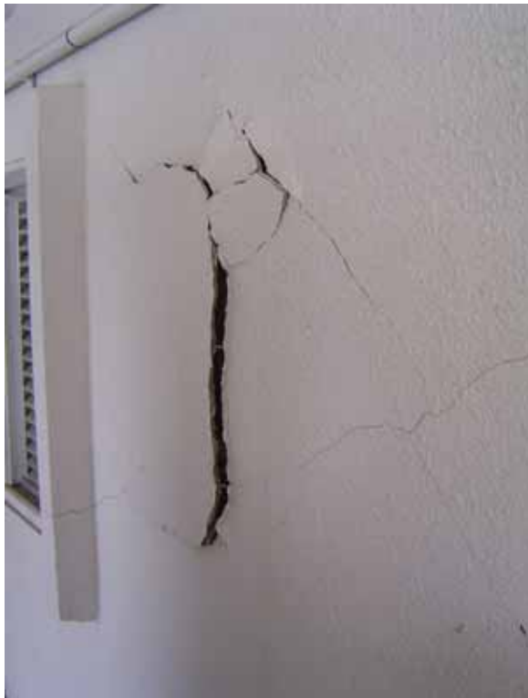
外壁のひび割れ
