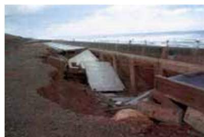
小松海岸陥没状況（平成16年1月）
