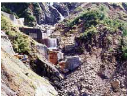
H4年の出水による柳谷第3号、第6号砂防えん堤の被災状況
