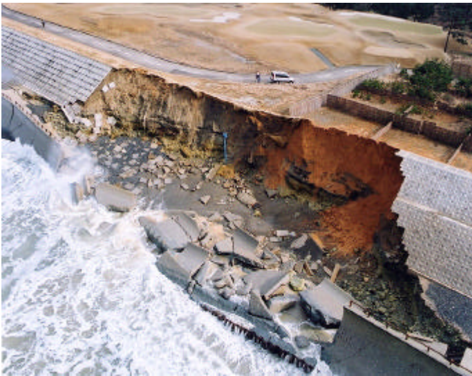
小松海岸での被災状況（平成12年1月）
