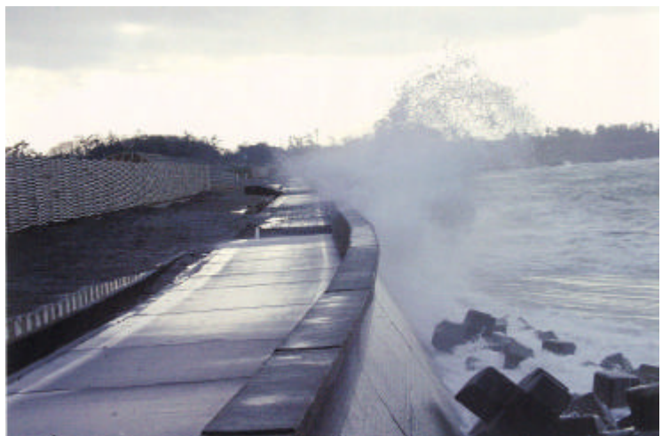
片山津海岸での越波状況（平成14年1月）
