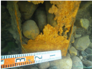
図-5 鋼矢板の破損状況
