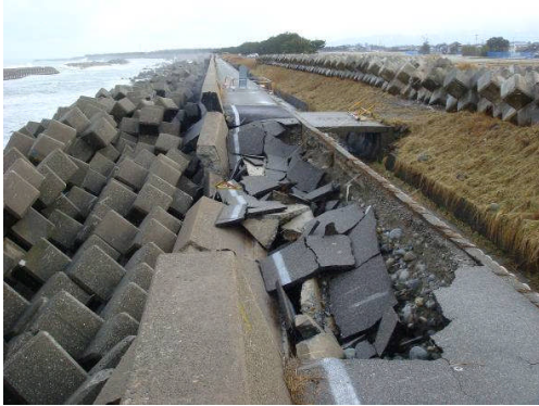
図-1 既設堤防の倒壊した状況
