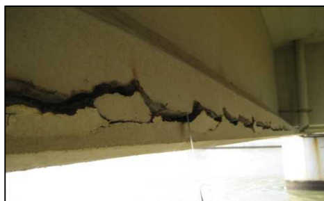
写真-3 第4経間G桁フランジのクラック
