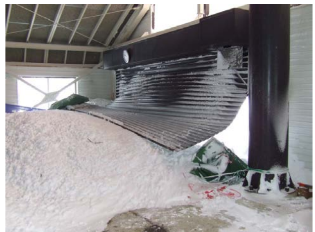
写真-6 被害を受けたスキー場施設(2月29日撮影)
