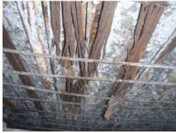
写真4 PCケーブル破断
