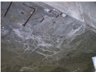
写真2 主桁のひび割れ
