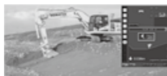
MC技術(バックホウ)の法面整形状況とコントロールボックス▶P.13
