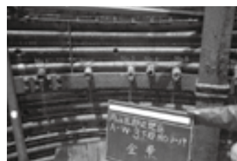
地すべり防止施設の老朽化状況 ▶P.7
