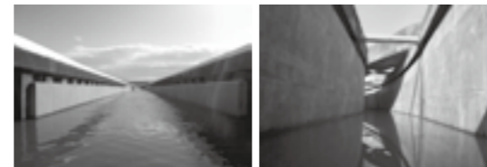
大断面の水路 狭隘で曲線的な水路 ストパネ工法による補修事例 ▶P.11
