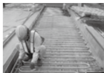
放熱管配管状況▶P.43
