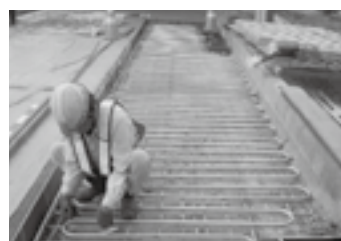
放熱管配管状況▶P.43
