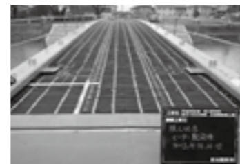
ロードヒーティング設置状況▶P. 5
