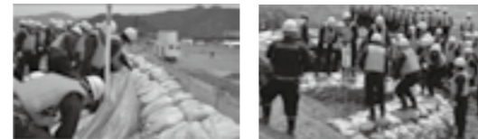
<改良積み土のう工> <月の輪工> 消防団による流域の特性にあった実践的な水防工法▶P. 3
