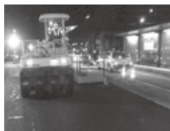
軌道敷上に一般車両が通行している 状況▶P. 7
