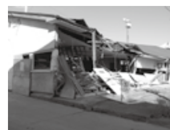
倒壊した木造の実習棟▶P.31
