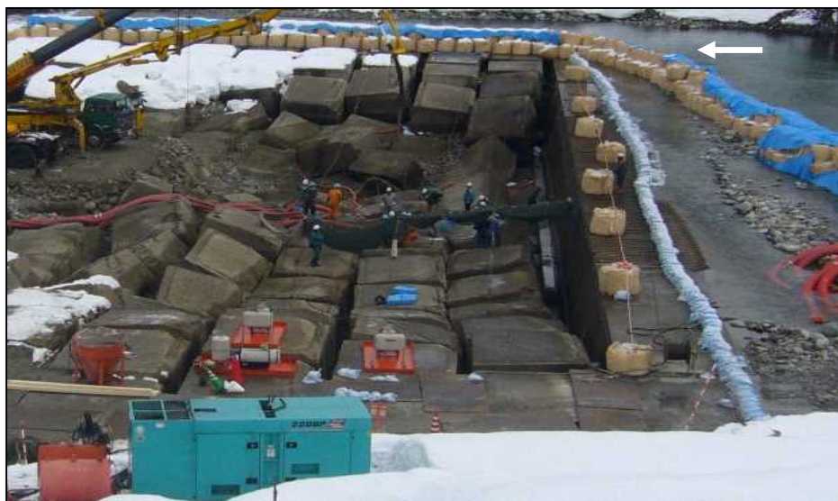
河床低下による愛本床止工の護床工沈下状況
