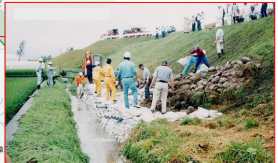
漏水による水防活動
