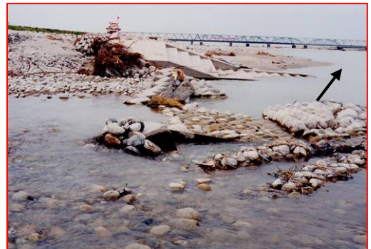
洪水流により護岸流失
