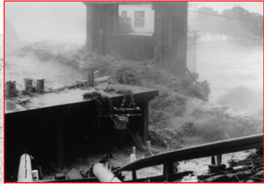
激流にさらされる旧愛本堰堤
