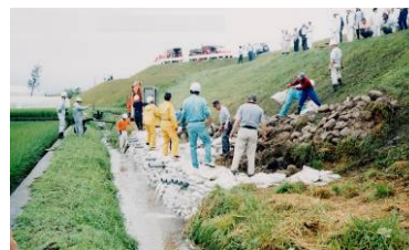
漏水による被災箇所 (平成7年7月洪水)
