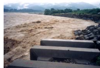
写真 5-6 洪水後の状況把握 (平成 10 年 7 月洪水)
