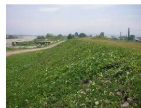
写真 3-12 堤防に繁茂する葛 (左岸 0.8k 付近)
