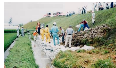
写真 3-2 漏水による被災箇所 (平成 7 年 7 月洪水)
