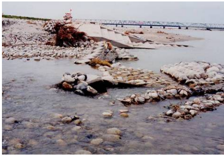
平成7年7月洪水 JR北陸線鉄橋上流左岸の護岸被災状況
