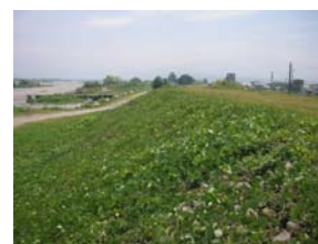
写真 3-12 堤防に繁茂する葛 (左岸 0.8k 付近)
