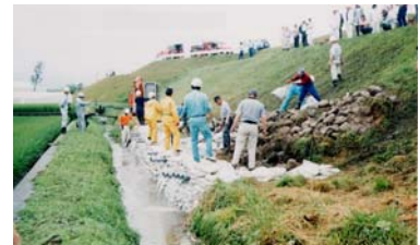
写真 3-2 漏水による被災箇所（平成 7 年 7 月洪水）
