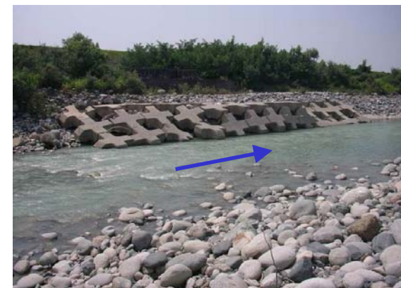
根固ブロック被災状況
