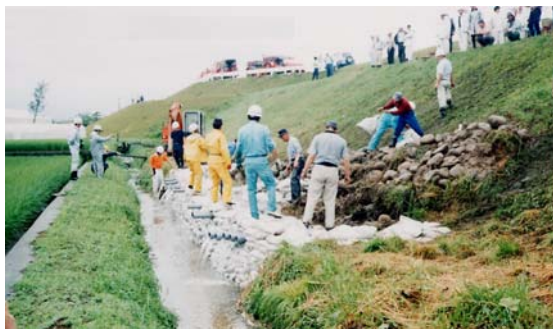
漏水による被災箇所(平成7年7月洪水)
