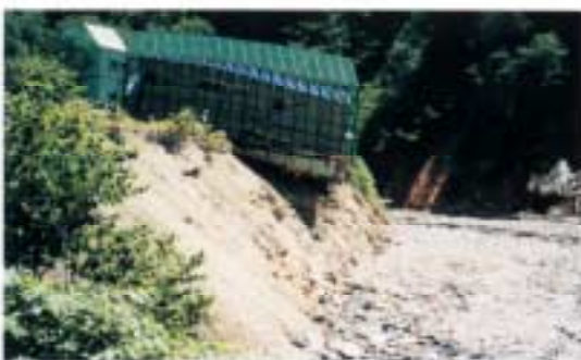
黒部峡谷作業員宿舎の被災状況
