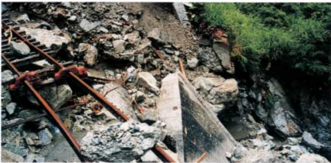
黒部峡谷鉄道黒川引込み線被災状況
